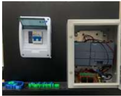
Figura 7.- PLC y conexiones del Tablero
